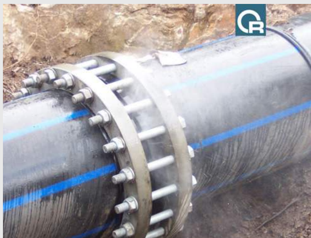
Bild 1: Undichtigkeit einer DN 600 Druckrohrleitung
